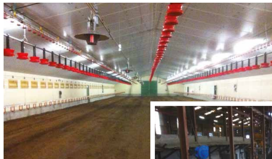
Exemples de réalisation en longrines isolantes dans un poulailler.
