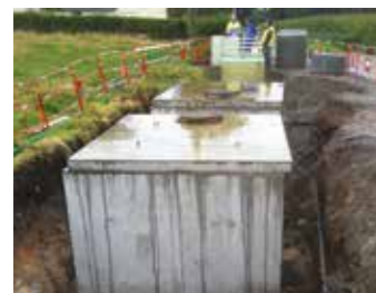
Bâche de stockage pour eaux usées avec traitement H2S.
