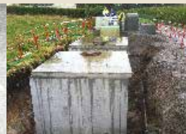
Bâche de stockage pour eaux usées avec traitement H2S.
