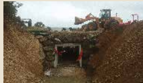
Pont cadre pour passage animaux 14 m L. x 2,20 m l. x 2 m h.
