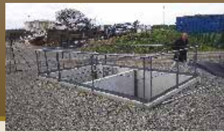
Deshuileur et débourbeur d'un recycleur de métaux.
