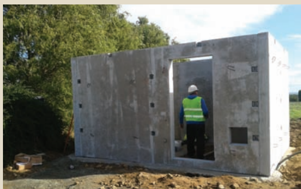
Local surpresseur avant pose.
