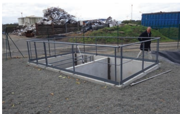
Deshuileur et débourbeur d'un recycleur de métaux.
