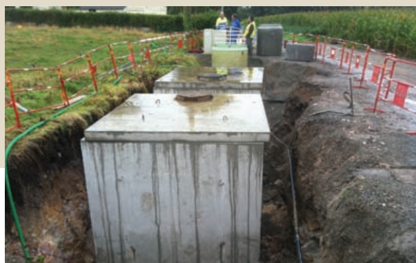
Bâche de stockage pour eaux usées avec traitement H2S.
